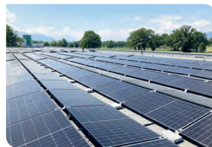
DC-Leistung der Photovoltaikanlage: 210 kWp Max. AC-Einspeiseleistung: 175 kW Jährliche Energieerzeugung: ca. 200.000 kWh
